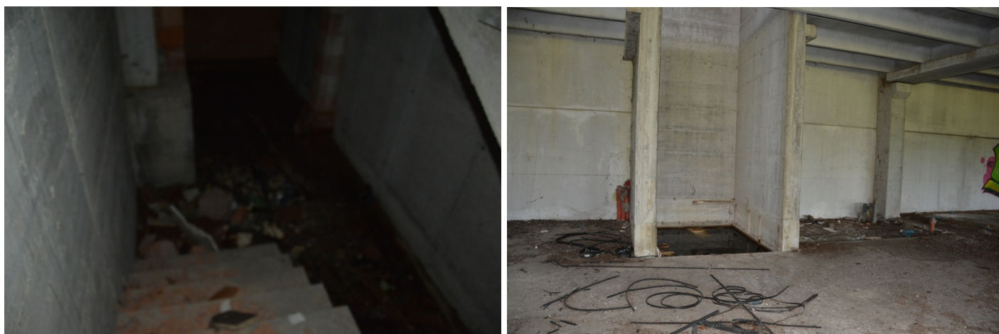
Piano interrato allagato
