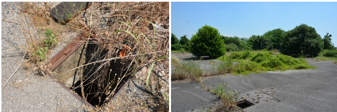
Pozzetti privi di chiusini
